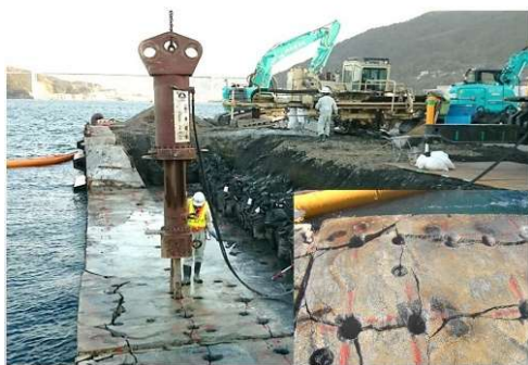
セリ矢による岸壁の破碎状況
